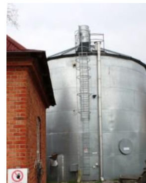
Figur 3: Nynäs slotts biogasanläggning.
